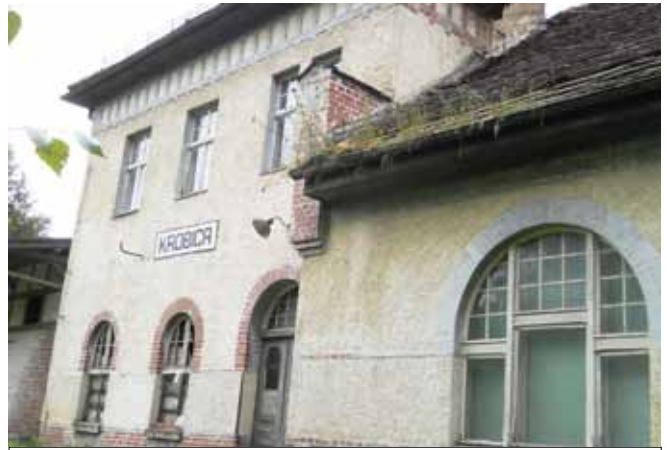
Zdewastowany dworzec kolejowy w Orłowicach (o nazwie Krobica, sąsiednia miejscowość), linia nieczynna, tory rozebrane / Fot. Autor
